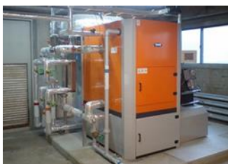
バイオマスボイラ
